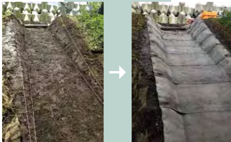
吐水口侵食防止工
