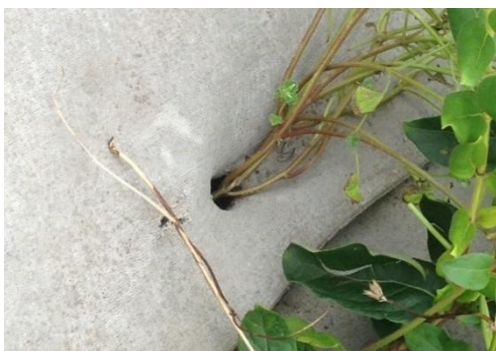
写真-20 打ち損じ穴からの発芽事例
